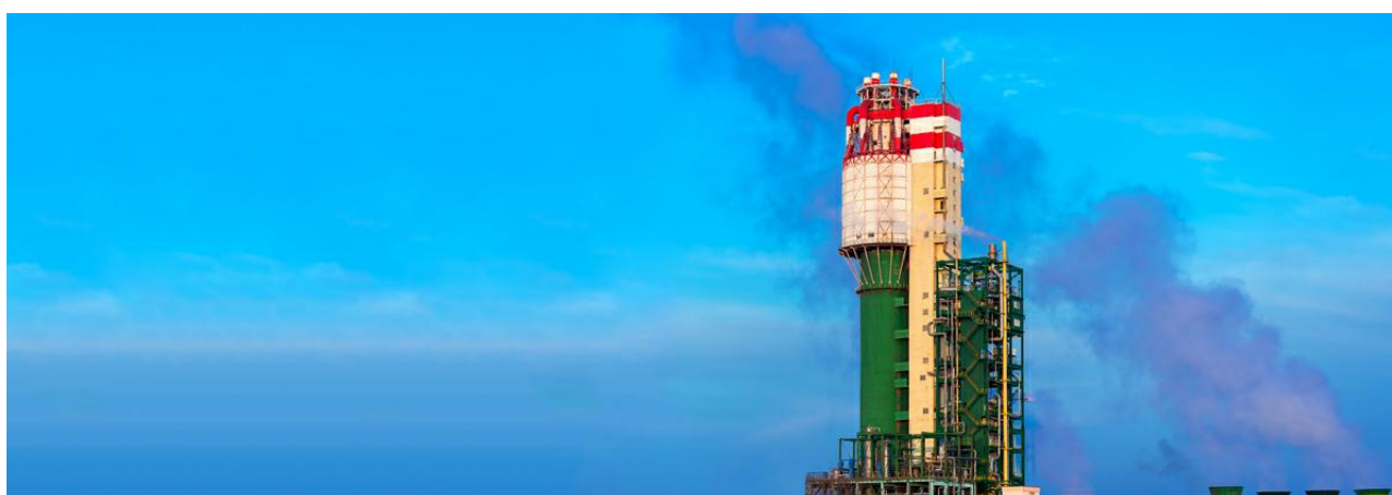
図1：アンモニアベースのガスを排出する化学処理プラントの排ガス塔
